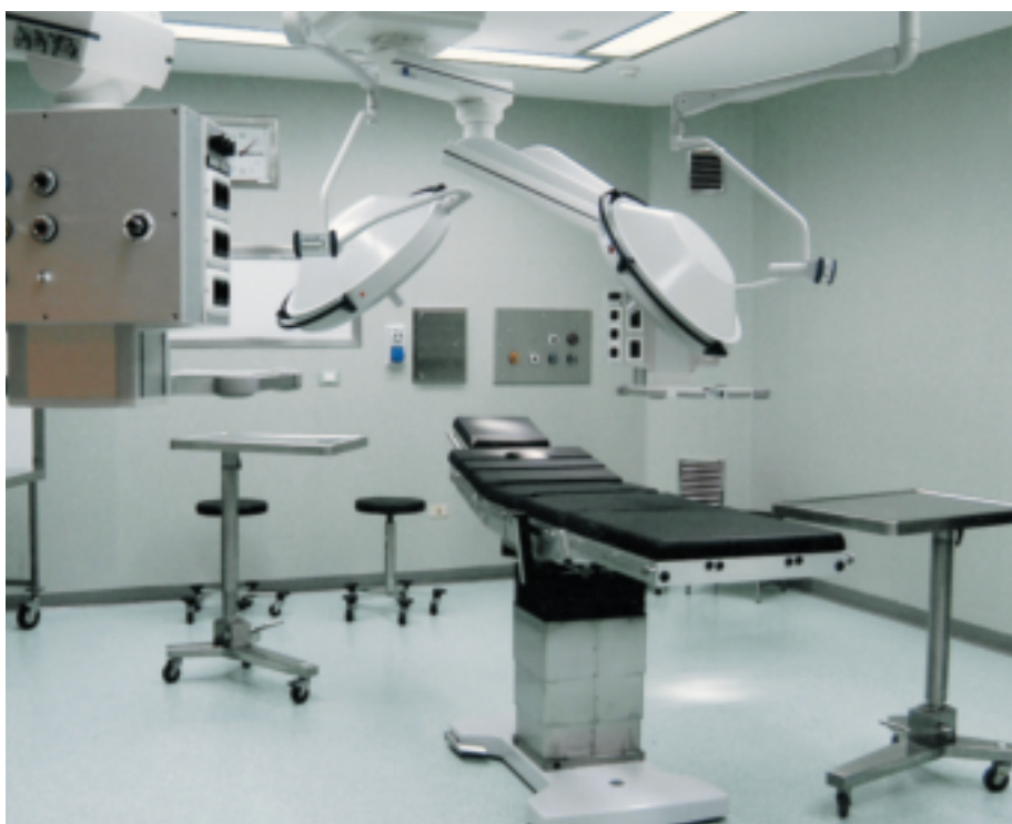
Le modernissime attrezzature di una sala del nuovo blocco operatorio
