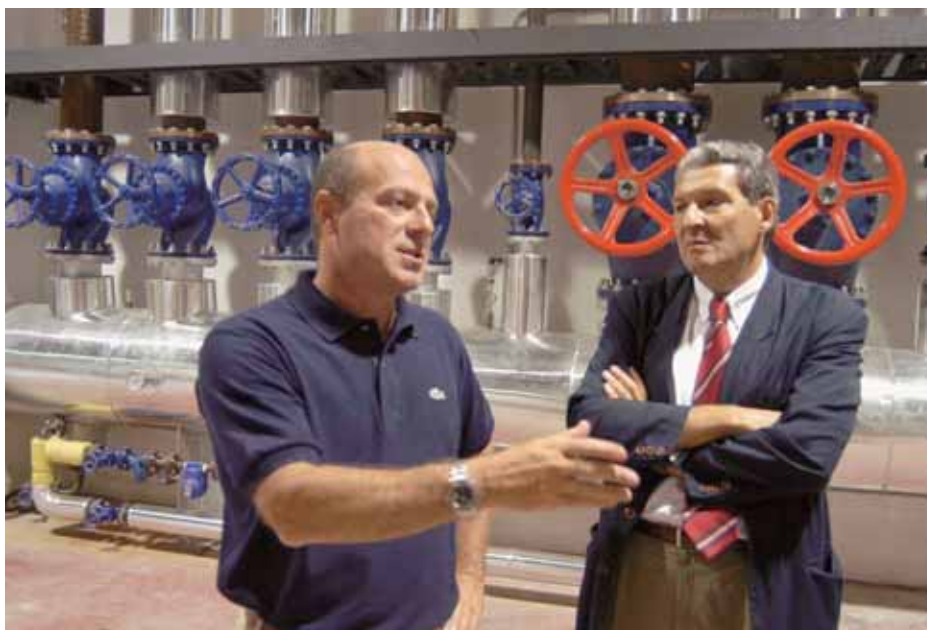
Da sinistra: l'ingegner Giorgio Finotti, progettista di Tifs con il direttore generale dell'Azienda ospedaliera Valerio Alberti nella sala caldaie della centrale
